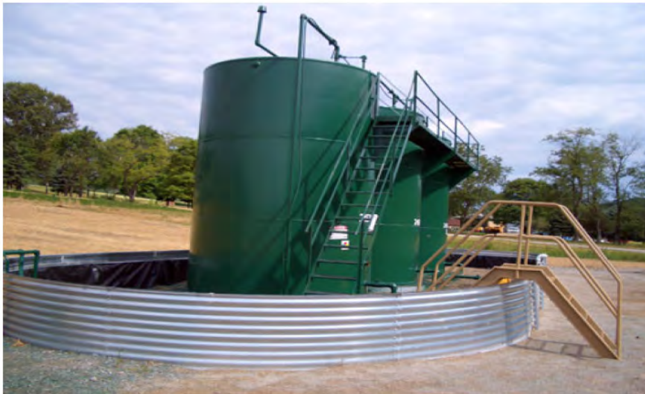
Afbeelding 2.8. Opslag voor productiewater en condensaat [ref. 2.]
